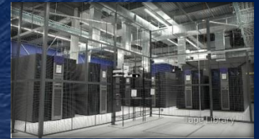
データ記録センター
