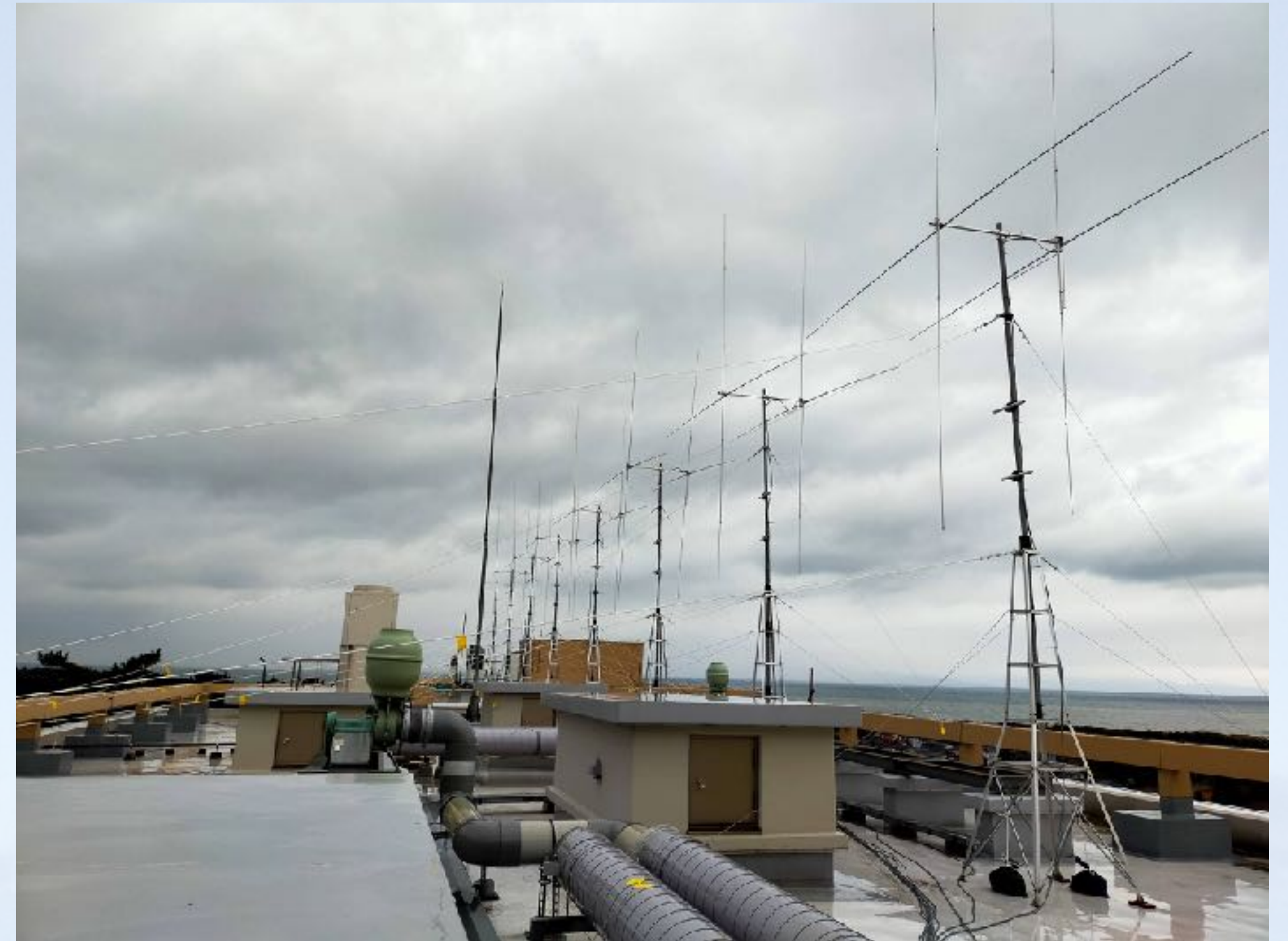
Rx Antenna array
